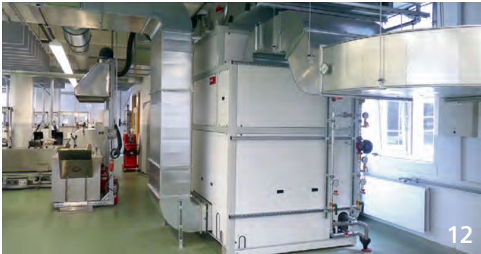
12: Lüftungsanlagen der Firma Hoval sorgen für eine effiziente Wärmerückgewinnung aus der Prozessabluft. Mit diesem schlaun System kann einiges an Heizenergie eingespart werden.
