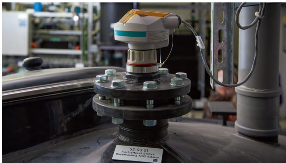
Im Sammel-tank überwacht der Füllstandsmesser Sitrans LG200 den oberen Füllstand. Dieser Sensor ist gleichzeitig auch in der Lage, die Trennschicht zwischen Wasser und Öl zu unterscheiden.
