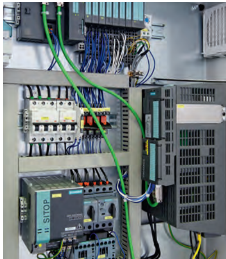
Der Sinamics G120 Umrichter rechts im Bild besteht aus einem Power Module und einer Control Unit. Das Operator Panel für den Umrichter ist bewusst nicht installiert, um dem Benutzer nicht zu verleiten, Einstellungen zu verändern.
