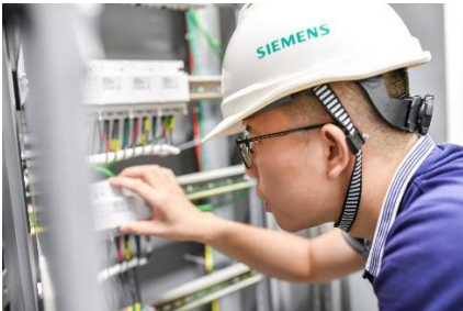
西门子赖童星精心调试楼宇自动化控制器，保证设备稳定运行。
