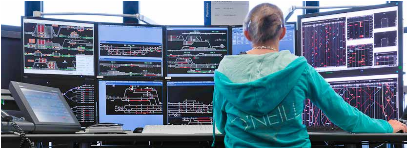
Iltis N Betriebszentrale
