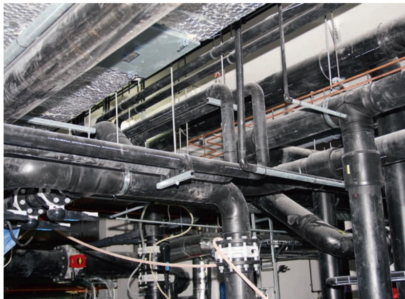
Det är mycket som ska regleras och styras. Under simhallen sitter många pumpar, ventiler och rör.
