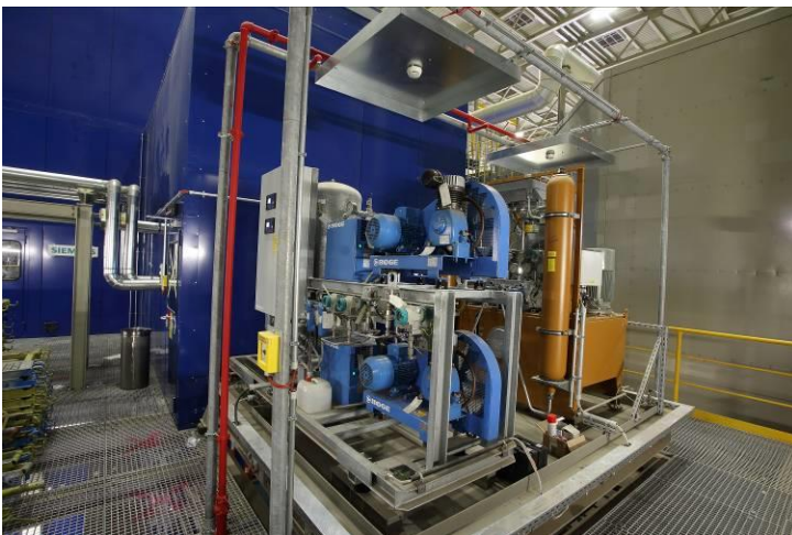
Bildunterschrift: Spezielle Technik erfordert einen speziellen Brandschutz. Hier: So genannte Rauchfangbleche und ein optischer Brandmelder. Quelle: Siemens AG
