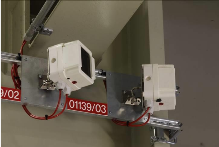
Bildunterschrift: Im Hauptgebäude des Kraftwerks kommen unter anderem lineare Brandmelder zum Einsatz. Quelle: Siemens AG
