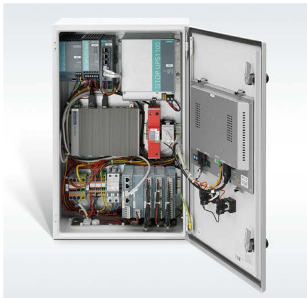
Fig. 6/13: Caja de automatización como aplicación de sistema del Microgrid Controller
