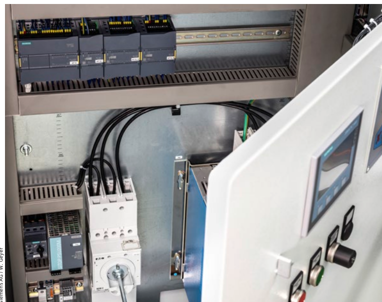
Simatic S7-1200 in der Ausführung CPU 1214FC lässt sich um bis zu acht Standard- oder fehlersichere Signalmodule erweitern – und entspricht exakt den Anforderungen und Wünschen von Dalex
