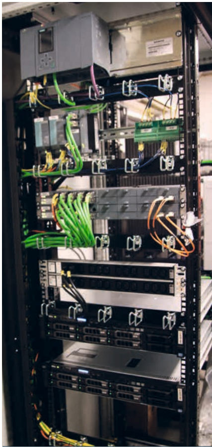
VIRTUALISERING. Virtualiseringsteknik från VMWare fördelar serverkraften. I skåpet sitter två ESXi-servrar som vardera innehåller fyra virtuella datorer med tunna klienter utplacerade i anläggningen. Huvud-plc:n Simatic S7-1517F är big boss.
