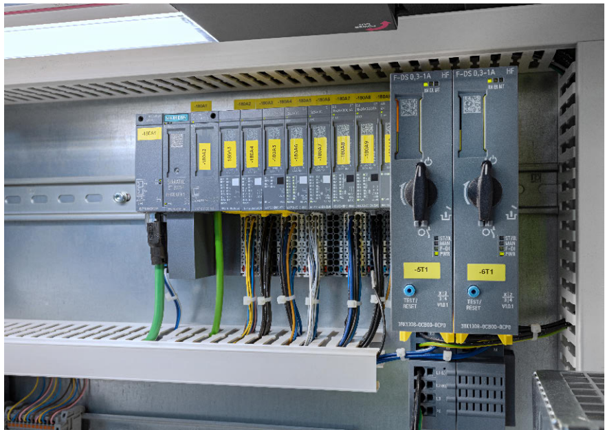
Bild 1 Die kompakten, fehlersicheren Motorstarter ET 200SP bieten durch ihre geringe Modul-Baubreite von nur 30 mm mehr Platz im Schaltschrank und lassen sich im TIA Portal schnell und einfach projektieren. Quelle: Siemens AG
