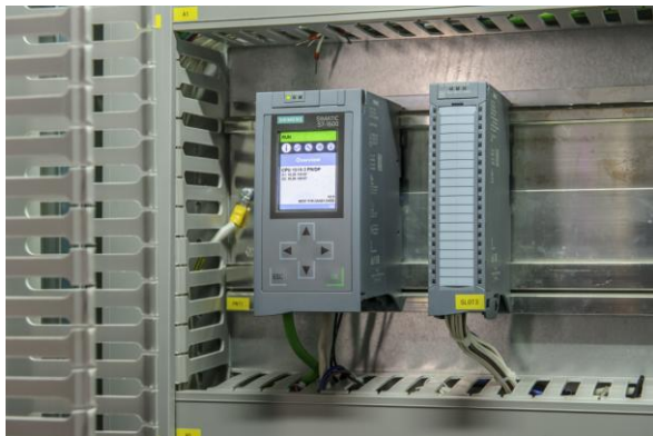
西门子 S7-1500 系列控制器等自动化设备覆盖整条试点线
