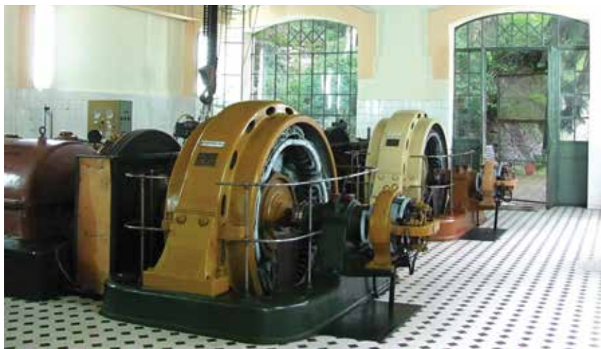
Водоелектрическата централа до казанлъшкото село Енина е построена през 1914 г. и продължава да работи и до днес
