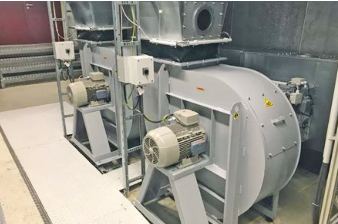
Abb.: Prozessabluftanlage für die Fertigungsbereiche des GWE
