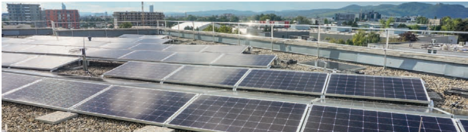
O parte din totalul instalației fotovoltaice de 1600 m 2 cu o putere maximă de 312 kW.
