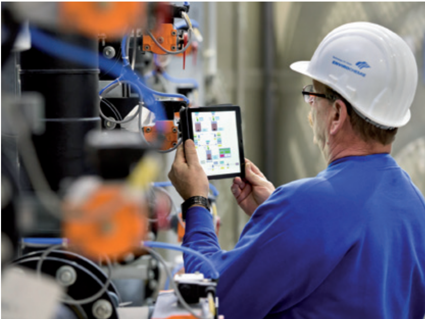
Abb. 5.4: Vor-Ort-Erfassung von Betriebszuständen und Anlagenkonfigurationen
