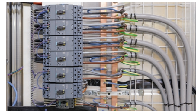
Die SF Elektro Engineering AG aus Flums übernahm das gesamte Elektroengineering für das Solarfaltdach sowie die anspruchsvolle Programmierung der S7-1500 Steuerung und des Leitsystems.
