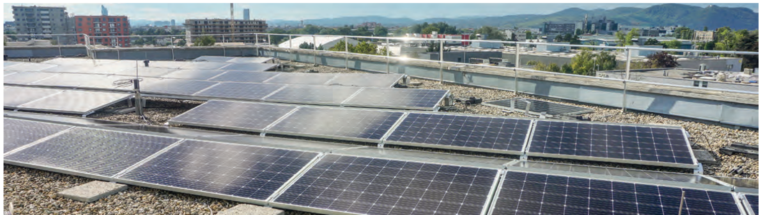
Del 1600 m 2 velike fotovoltaične instalacije z največjo močjo 312 kW.
