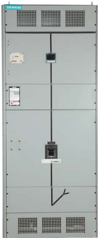
Switchboard con Sm@rt DAS
