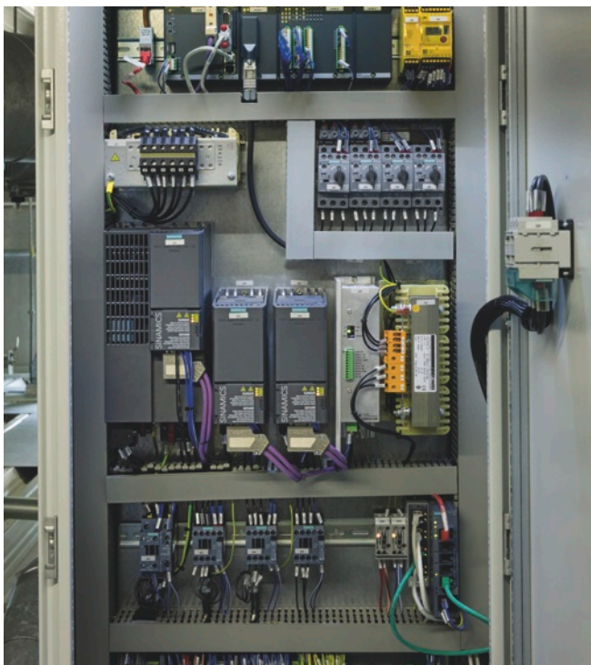
Die Schaltschränke bei Aesica Pharmaceuticals wurden komplett neu aufgebaut.
