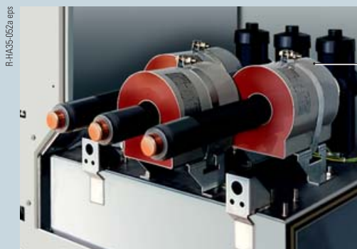
Трансформаторы тока сборной шины Пример 1250 А
