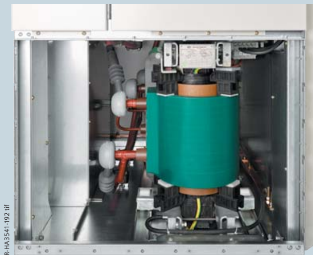
Отсек вспомогательного трансформатора ячейки TCH
