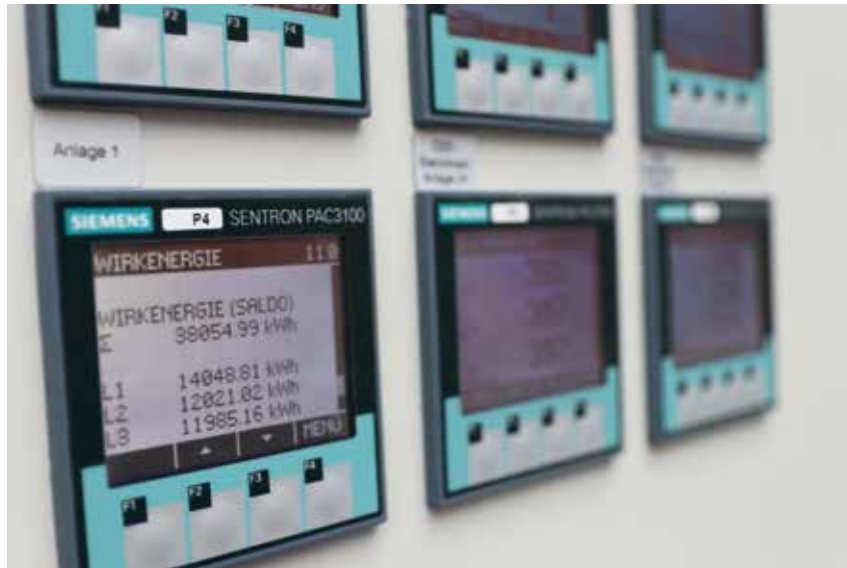
04 Drei Typen von Strommessgeräten der Sentron-7KM-PAC-Reihe von Siemens kommen zum Einsatz.
