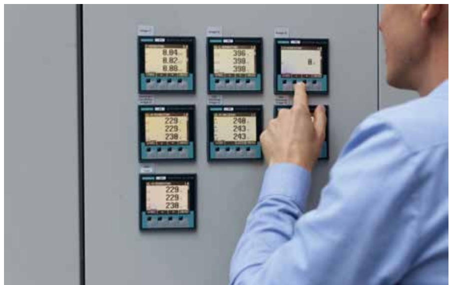
03 Der Sentron Powermanager erschließt detaillierte Echtzeitdaten über Energieflüsse auf allen Ebenen des Prozesses.
