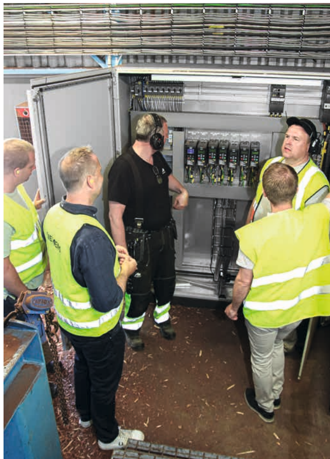
Snygg och luftig installation tack vare kommunikation via buss.
