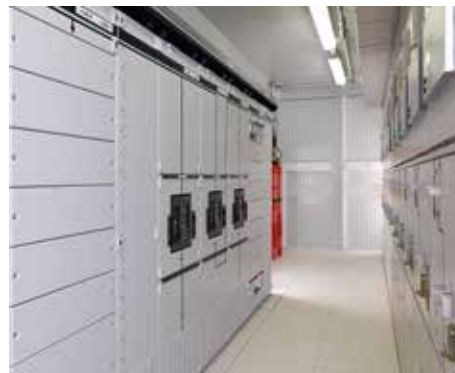
Оборудование низкого и среднего напряжения в модульном здании
