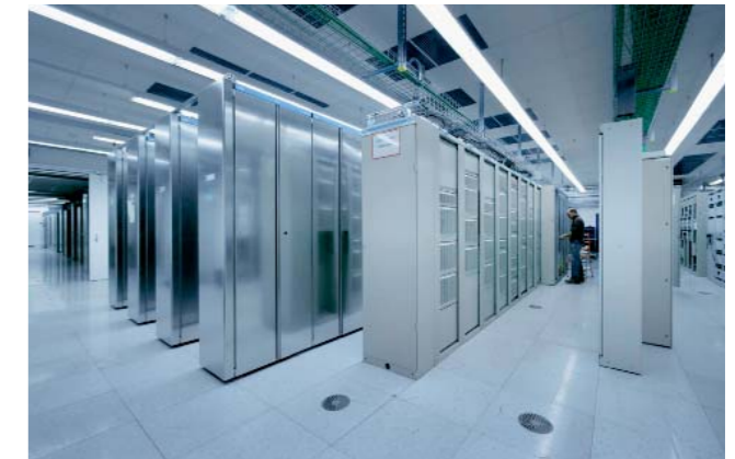
Sähkö- ja atk-tilat
