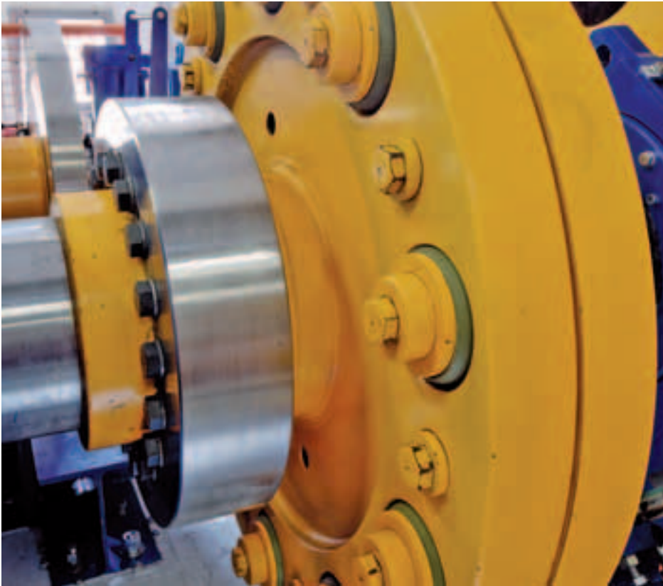
Die Siemens Flender Rupex-Kupplung verbindet das Getriebe mit der Antriebswinde.
