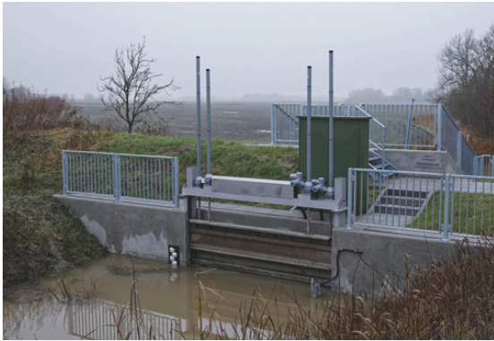
Modernisiert und ferngesteuert: Das Adenbüllersiel ist eine der fünf Sielanlagen, die im Rahmen eines Pilotprojekts an die Zentralsteuerung angeschlossen wurden.
