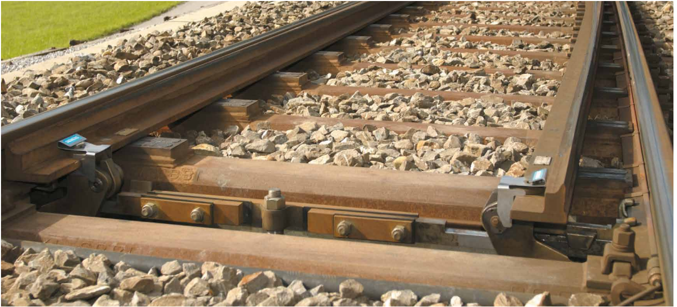
In eine Weiche installierter Klinkenverschluss
