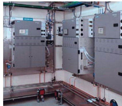
Siemens PGC in a plant.
