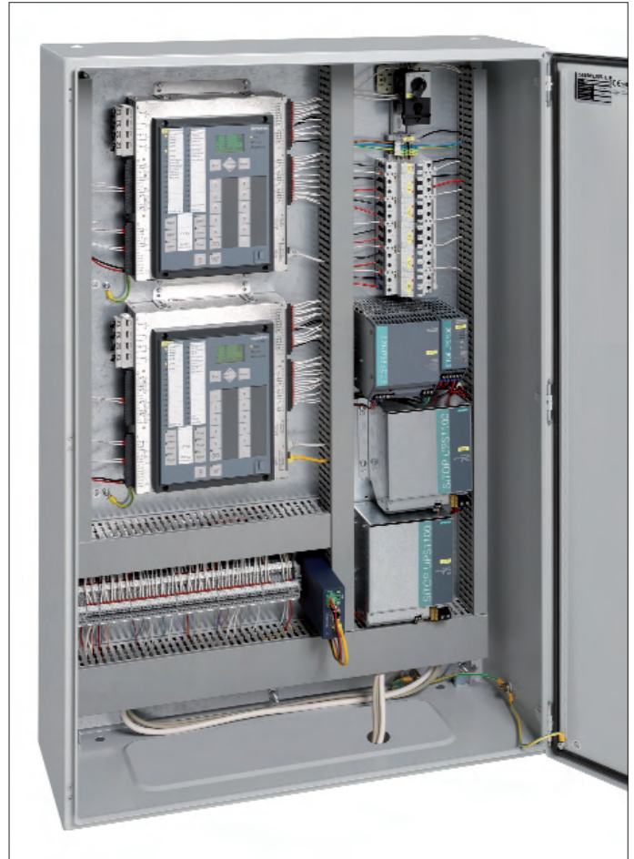
Bild 1: Haben sich für Schutz- und Automatikfunktionen in der primären Verteilebene bewährt: Verteilnetzautomatisierungseinheiten der Bauart Siprotec 7SC80. Primärschaltgeräte wie Erder, Trenner und Last-/Leistungsschalter können herstellernabhängig überwacht und in Automatisierungsfunktionen integriert werden.
