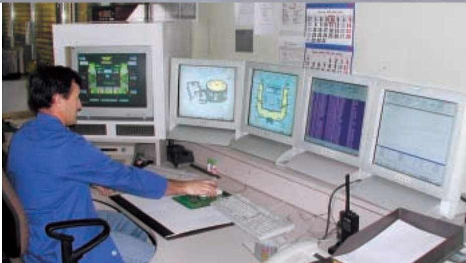
Die neue Simatic PCS 7-Leitwarte.
