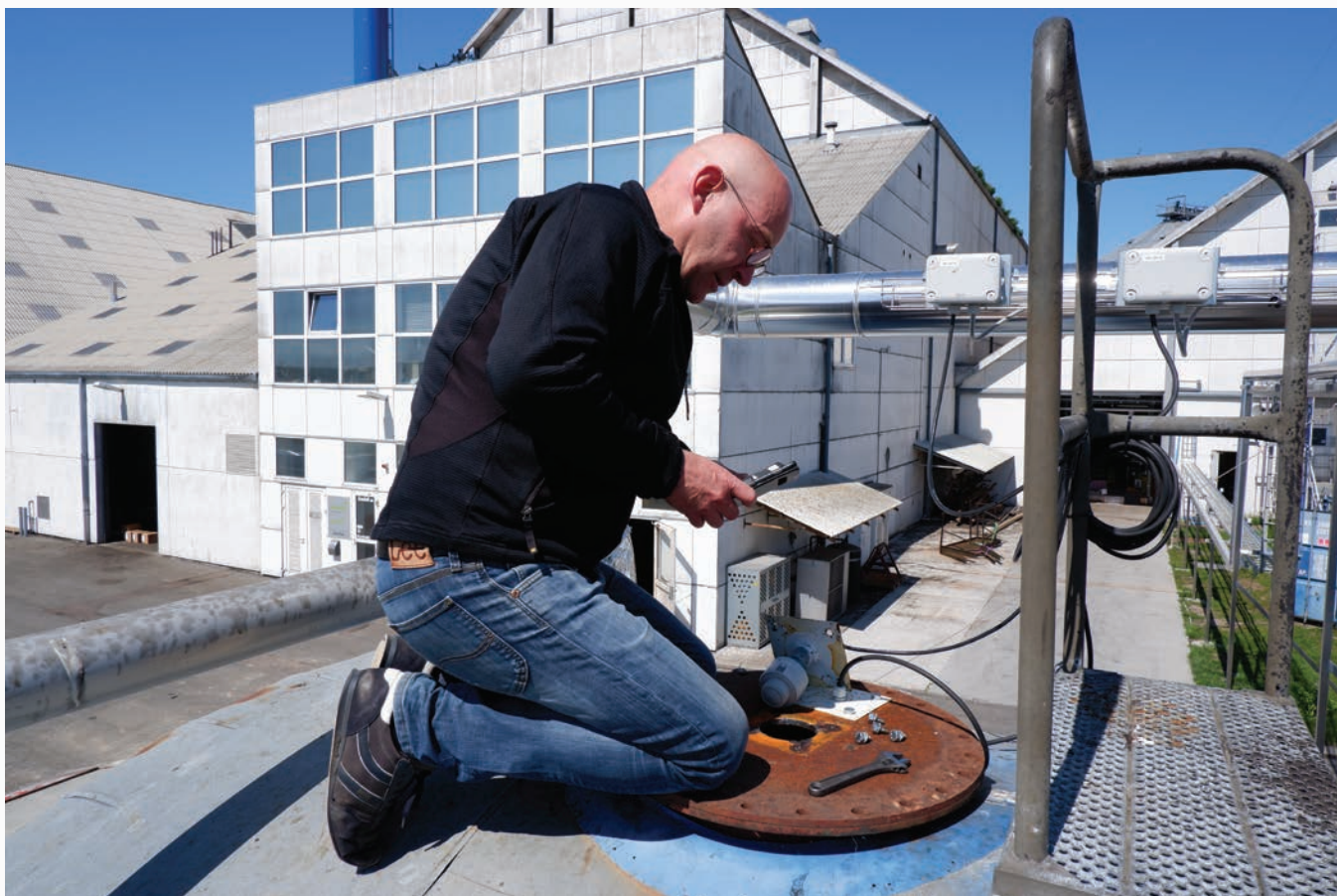
Henrik Nielsen, adm. direktør i TPI EI & Automation, i gang med installation af en SITRANS LR 100.
