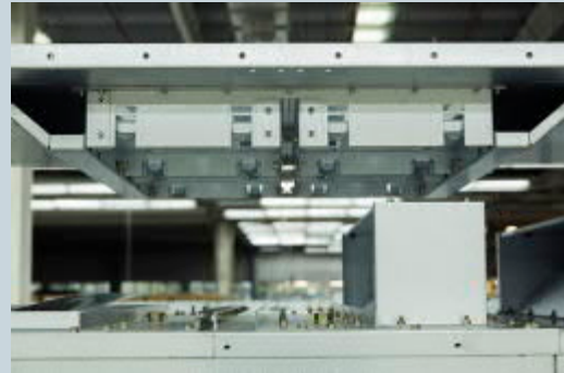
Канал сброса давления (часть)
