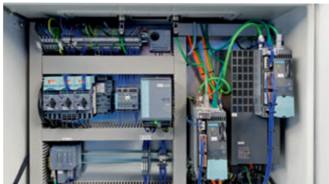
Chaque module est piloté par sa propre petite armoire de commande.
