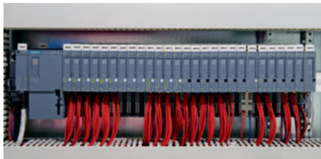
Un coup d'œil dans l'armoire de commande: Le pont autoporteur est piloté par une Simatic S7-1500 de sécurité de Siemens.
