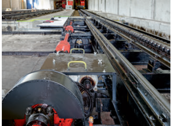
16 Une mécanique solide dotée d'une commande de dernière génération, Pilatus-Bahnen AG
