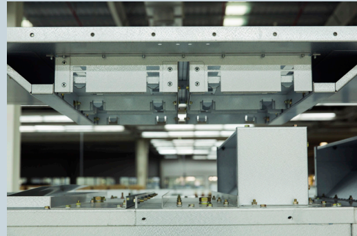
Канал сброса давления (часть)
