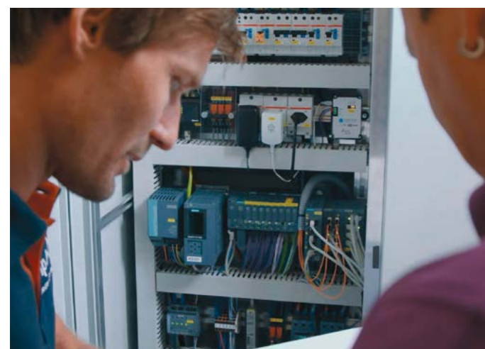
Der Betrieb des Daches erfolgt mit einer Simatic S7-1500.
