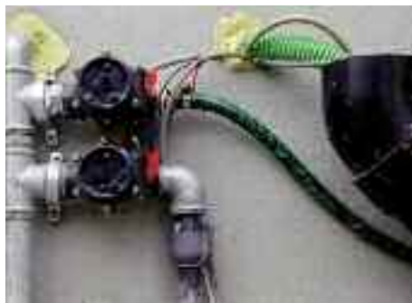
Zur Bewässerungsanlage gehört ein System von Ventilen und Schläuchen.
