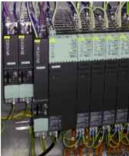
Für die Steuerungstechnik wurde das Motion-Control-System Simotion D445 von Siemens in Verbindung mit Sinamics S120 eingesetzt.
