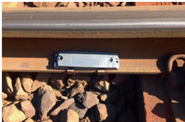
Streckenseitig sind pro Räumungszone vier passive RFID Tags jeweils in der Schienenkehle mit einer Klemmvorrichtung befestigt.
