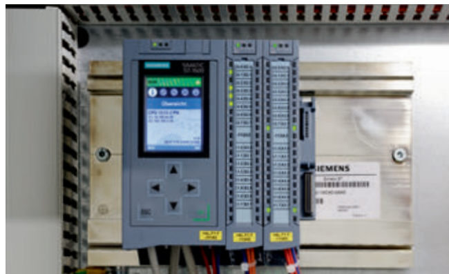
Die eingesetzten Siemens Simatic S7-1500 Steuerungen entsprechen dem neusten Stand der Technik und sorgen dafür, dass die Jowa Bäckerei problemlos und sicher produzieren kann.
