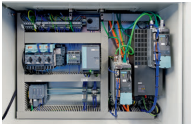
Jedes Modul wird über seinen eigenen kleinen Schaltschrank gesteuert.
