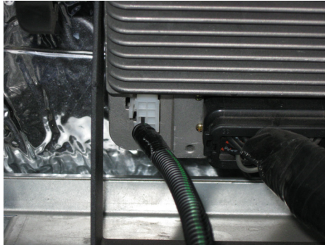
Figure 2.2 – Câblage installé sur le régulateur.
