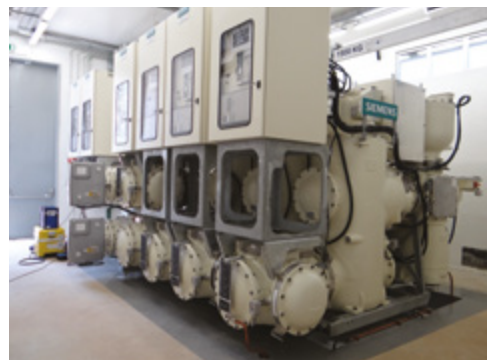
Subestação de Chicala
