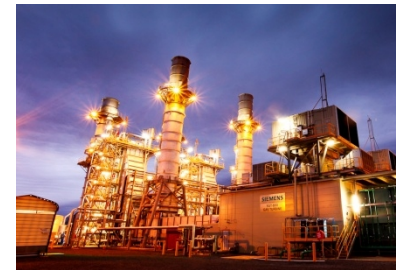
Hauptsächliche Anwendung: Industrielle Energieerzeugung
