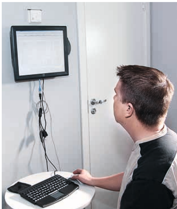
ÖVERSIKT. På skärmen i hallen ser man översiktsbilder med driftstatus över hela huset. I Simatic WinCC har program gjorts för de olika delarna av huset. Allt kan styras via surfplattan eller mobiltelefonen.
