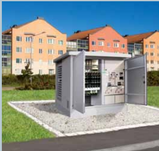
Ortsnetzstation – kompaktes Design für neue Kompaktstationen
