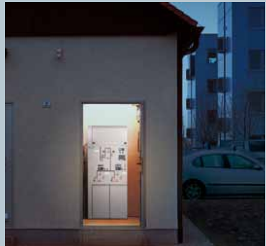
Retrofit – optimales Design für effektive Nutzung von Schaltanlagenräumen
