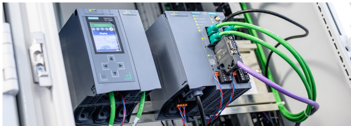
Das Bild zeigt von links nach rechts die komplette Kommunikationskette: Steuerung SIMATIC S7-1500, cloudfähiger Kommunikationsprozessor SIMATIC CP1545-1, geregelte Stromversorgung SIMATIC PM 1507, cloudfähiges IIoT-Gateway SIMATIC CC716, LTE- bzw. 4G-Mobilfunkrouter SCALANCE M876-4.
