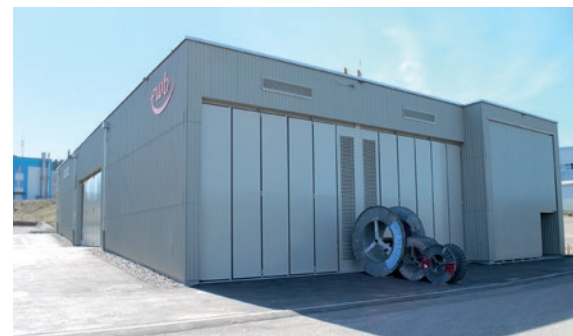
UW Riedbach, Falttore zu den Leistungstransformatoren
