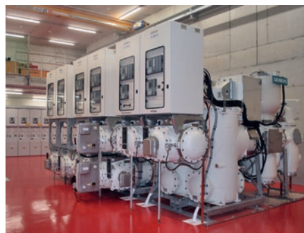
Hochspannungsanlage 132 kV (145 kV)
