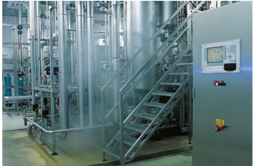
Die permanente Überwachung der Sauerstoffkonzentration verhindert ein mögliches Entzünden von Gasen.
