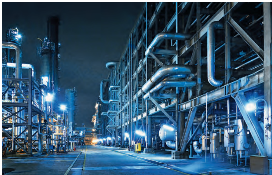
Sistemi za preplavljanje z vodo se uporabljajo tam, kjer bi se ogenj lahko hitro razširil, na primer v rafinerijah in na deponijah odpadkov.
