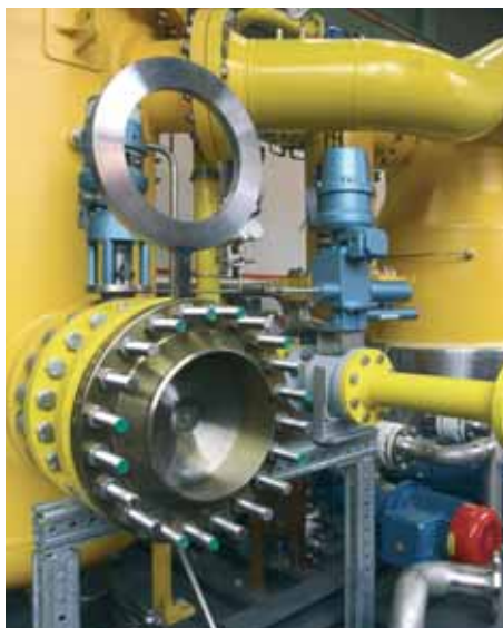
Imposante Komponenten der Baugruppe: Links der Filter zur Gasreinigung mit der grossvolumigen Ansaugleitung des Verdichters, in der Bildmitte der Ölabscheider und im Vordergrund die viel kleinere Druckleitung.
