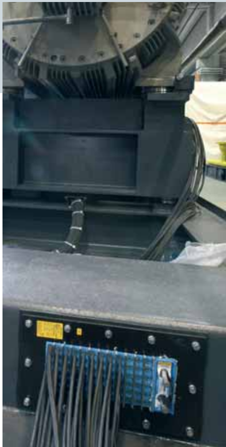
Ein weiteres «kleines» Detail: Alle Kabel werden gasdicht durch den Rahmen der Verdichtergroupe dem Steuerschrank zugeführt.
