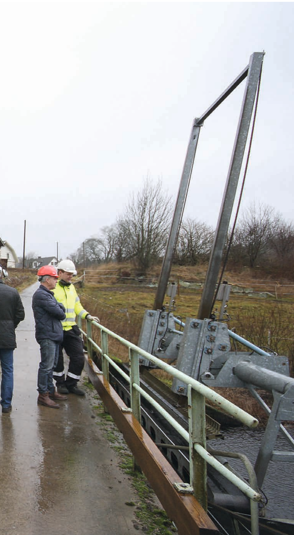
Pumpstationen i Gällared uppfördes 1949. Från Gällaredsbäcken till höger pumpas vatten upp 1,2 meter till Bällforsendammen. En vattenkraftstation sitter i dammens andra ände.
