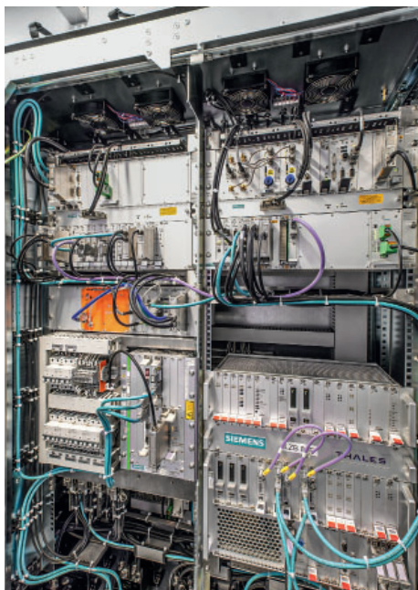
Der Zugsicherungsschrank mit Trainguard 200 OBU, TBL1+, LZB 80E und ATB EG (Foto: Siemens).
