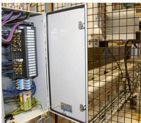
Distribuerade I/O med hjälp av Simatic ET 2005 har givit betydligt mindre kabeldragning på maskinen.
