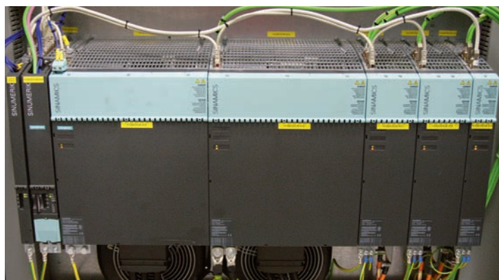
Bättre och snabbare maskin med modern styrning och kraftfullt servosystem: det gamla systemet byttes ut mot den nya generationen cnc-styrssystem Sinumerik 840D solution line med Sinamics S120. Motordata och pulsgivarinformation överförs via Drive-Clq.
