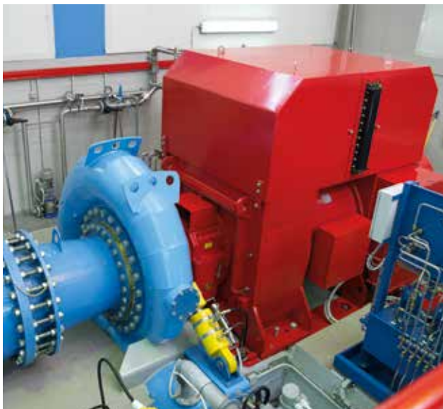
Francis turbin, synkrongenerator og hydraulisk enhet
